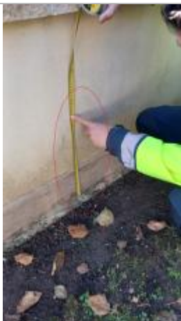
Laisse de crue à 45 cm/rebord en béton.
