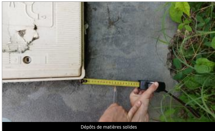
Dépôts de matières solides
