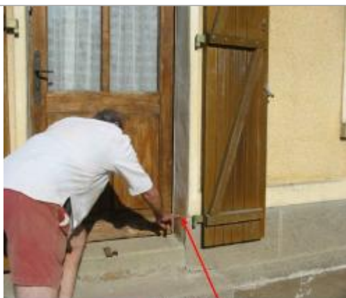
Relevé laisse d'inondation au niveau de la porte d'entrée
