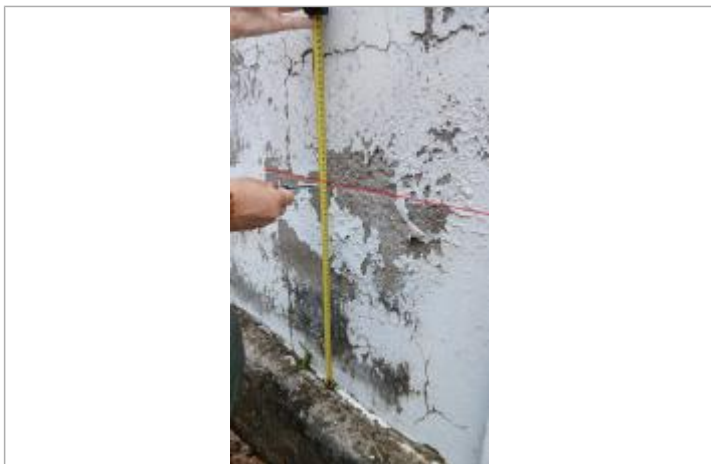
Témoignage d'une hauteur d'eau
