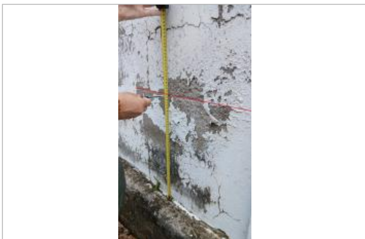
Témoignage d'une hauteur d'eau
