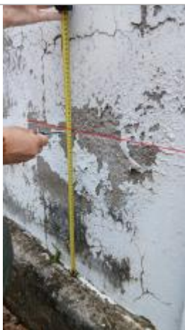
Témoignage d'une hauteur d'eau
