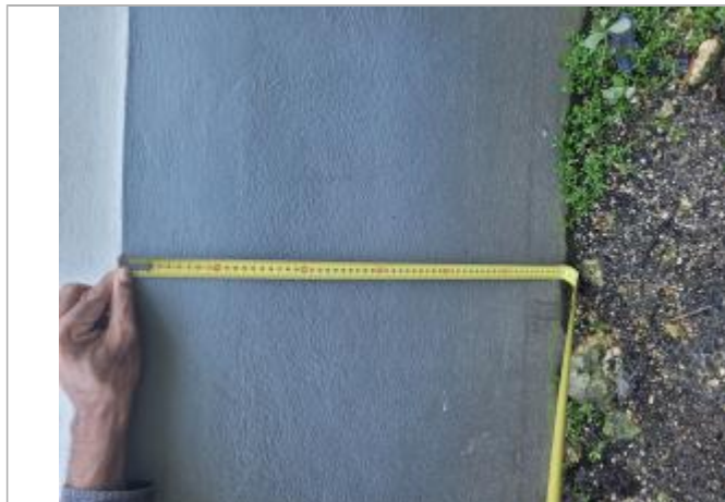
Dépôts de matières solides
