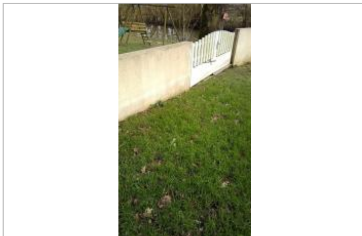
Muret d'une propriété bordant le Don le 05/02/2025 - photo SPC MLA
