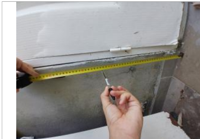
Dépôts de matières solides à gauche de la porte
