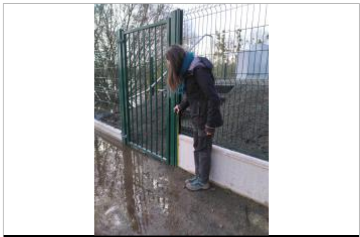
Dépôt de sédiments/végétation sur le muret. Mesure collée à la limite droite de la porte.
