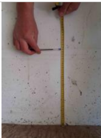
Laisse de crue à 36 cm/sol.
