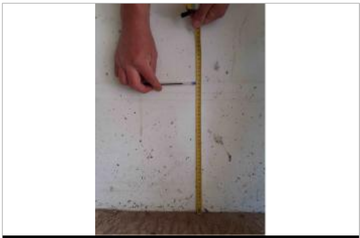
Laisse de crue à 36 cm/sol.
