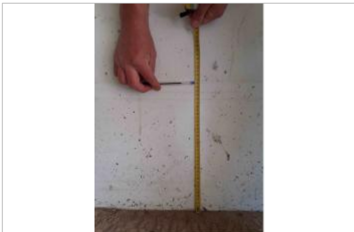
Laisse de crue à 36 cm/sol.
