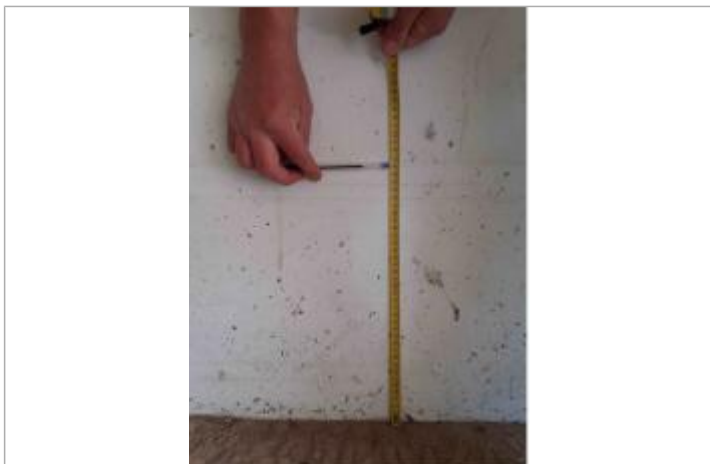
Laisse de crue à 36 cm/sol.
