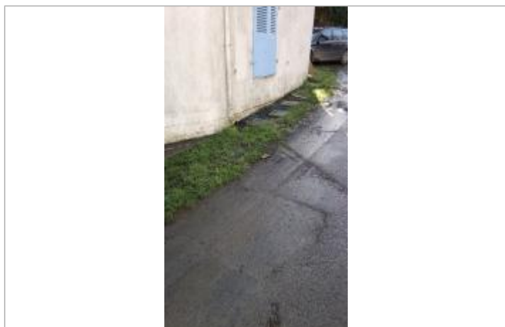
Relevé de la laisse du mur du bâtiment le 05/02/2025 - photo SPC MLA
