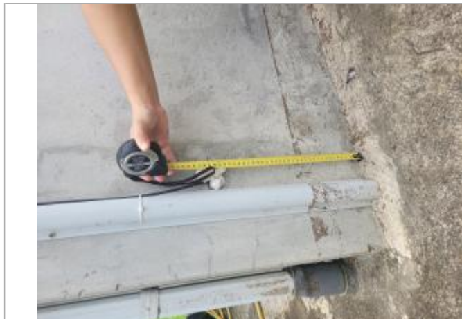
Dépôts de matières solides
