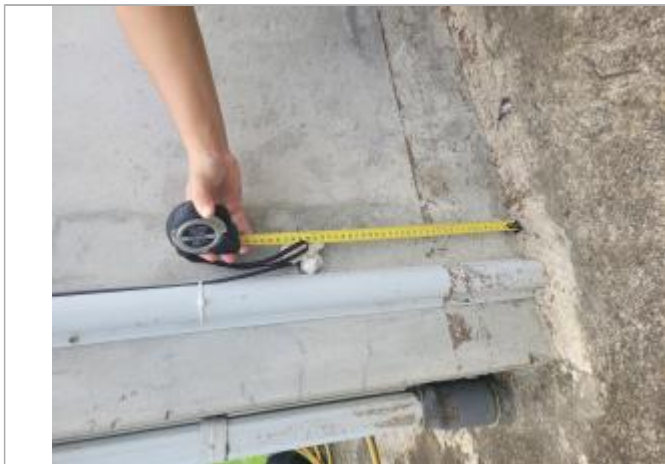
Dépôts de matières solides
