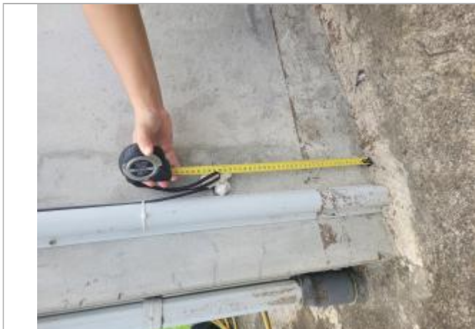
Dépôts de matières solides
