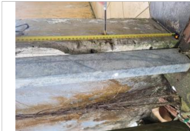
Témoignage d'une hauteur d'eau
