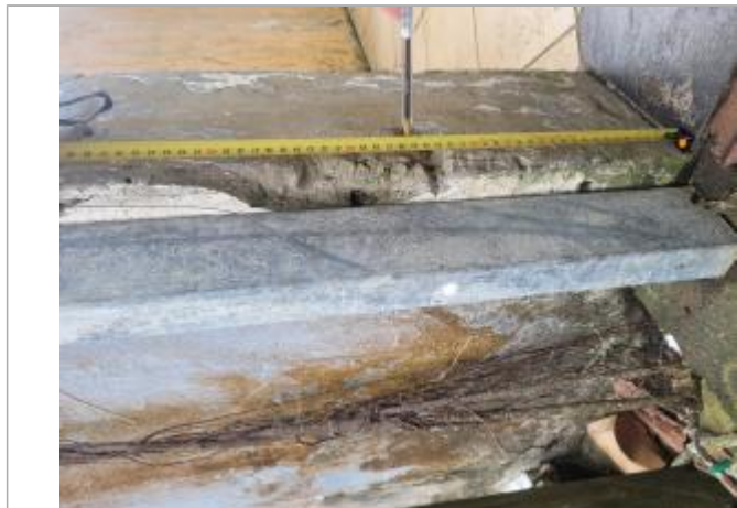
Témoignage d'une hauteur d'eau
