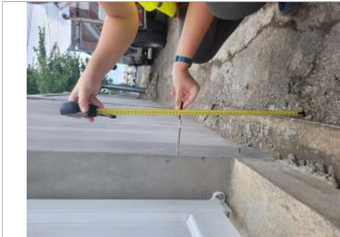
Dépôts de matières solides
