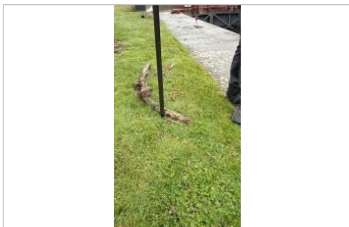
Relevé de la laisse d'inondation sur le terre-plein de l'écluse
