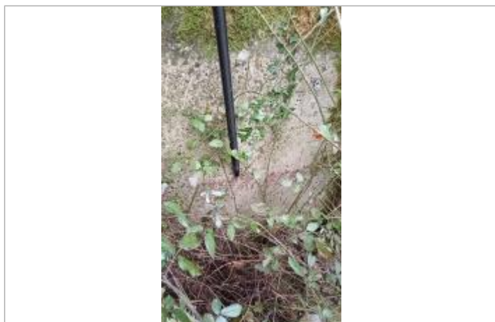
relevé de la laisse d'inondation sur la maçonnerie du pont le 05/02/2025 - photo SPC MLA
