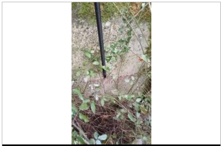
relevé de la laisse d'inondation sur la maçonnerie du pont le 05/02/2025 - photo SPC MLA
