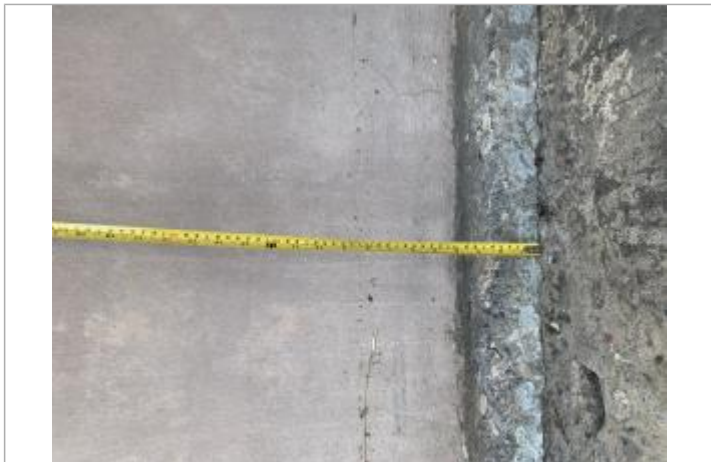
Dépôts de matières solides
