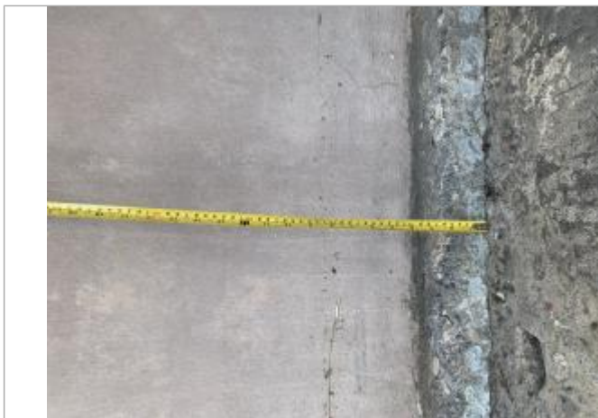
Dépôts de matières solides
