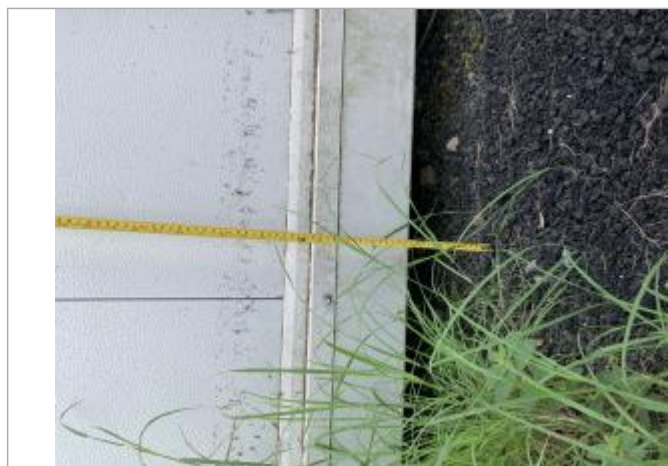
Dépôts de matières solides
