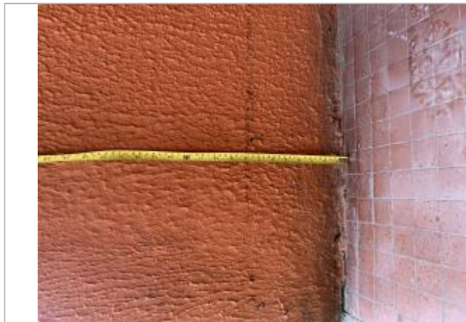
Dépôts de matières solides
