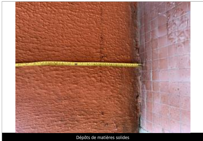
Dépôts de matières solides
