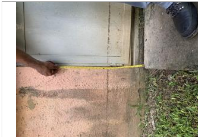
Dépôts de matières solides
