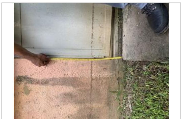
Dépôts de matières solides
