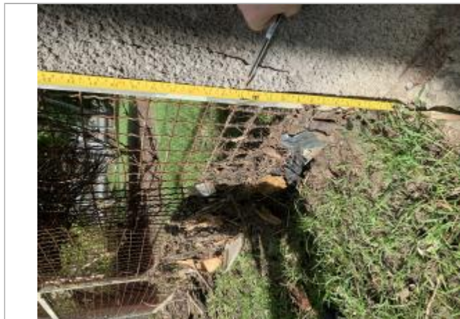
Dépôts de matières solides
