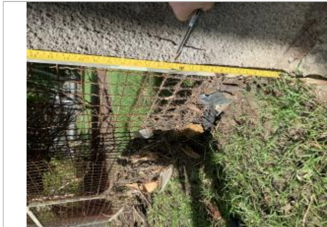
Dépôts de matières solides
