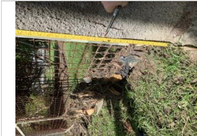
Dépôts de matières solides
