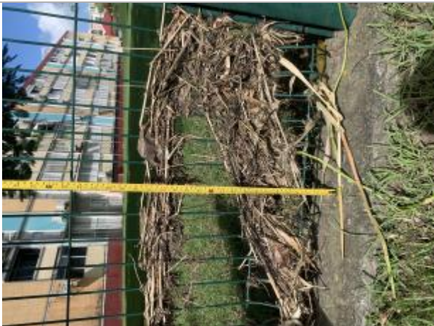
Dépôts de matières solides
