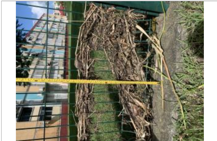
Dépôts de matières solides
