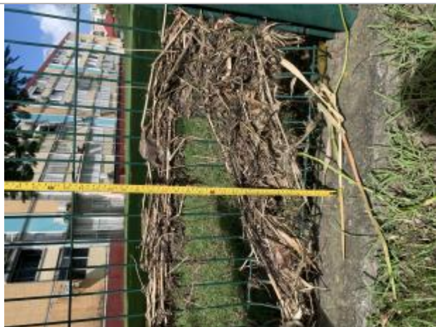
Dépôts de matières solides
