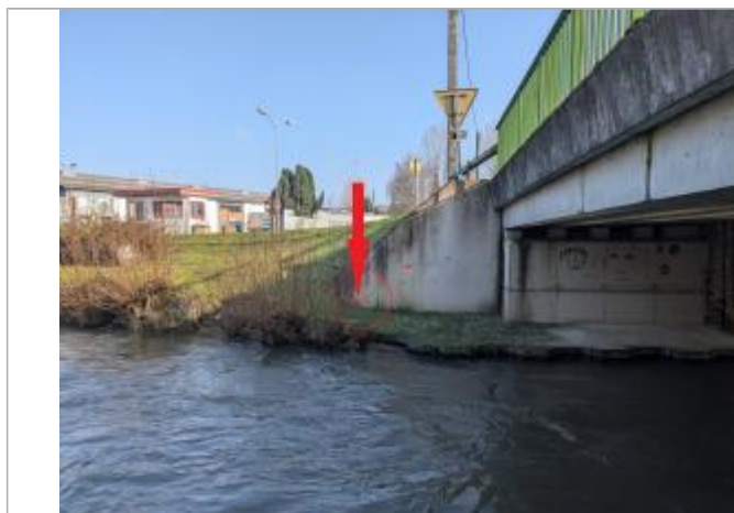
Laisse de crue à la base du pilier
