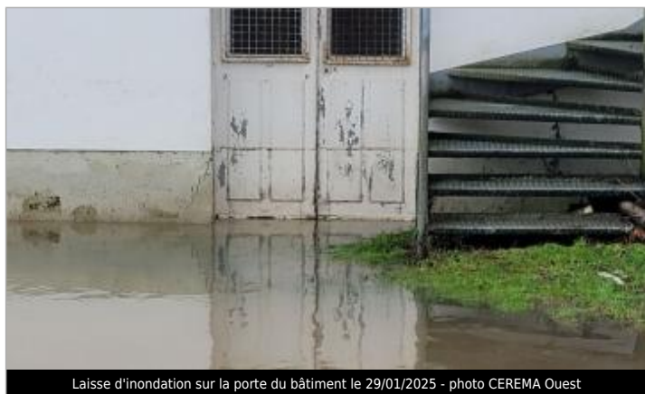
Laisse d'inondation sur la porte du bâtiment le 29/01/2025 - photo CEREMA Ouest
