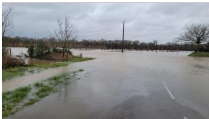
Inondation du chemin de pan le 29/01/2025 en début de décrue - photo CEREMA Ouest
