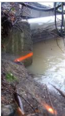
Marque à la peinture sur la pile de pont - photo DDTM 35 le 29/01/2025
