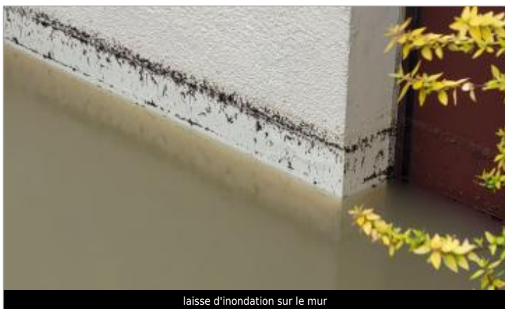
laisse d'inondation sur le mur
