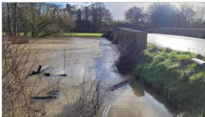
Pont de Vaugon le 28/01/2025 - photo CEREMA Ouest
