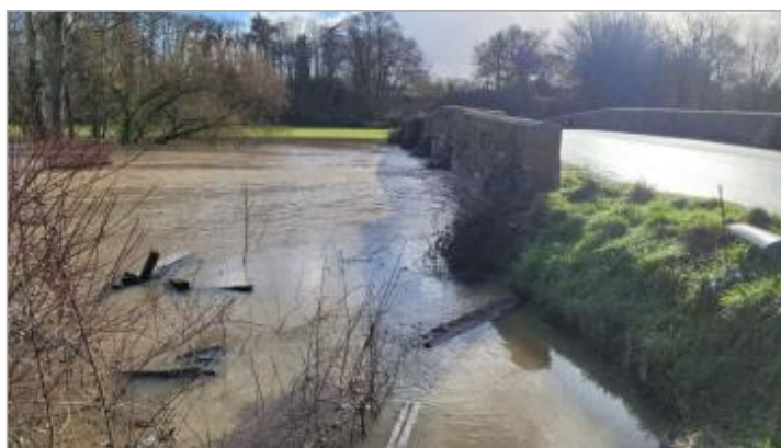
Pont de Vaugon le 28/01/2025 - photo CEREMA Ouest
