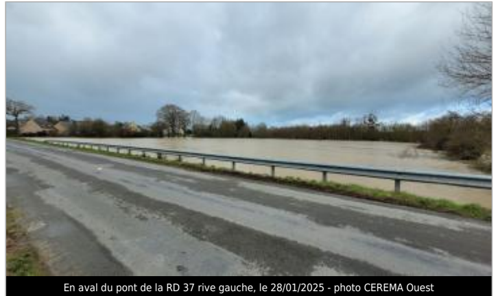
En aval du pont de la RD 37 rive gauche, le 28/01/2025 - photo CEREMA Ouest
