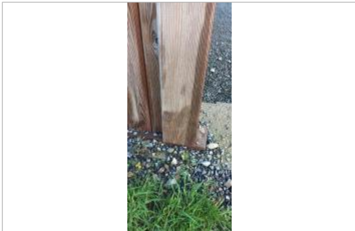
Marque sur le poteau d'un abri vélo du parking
