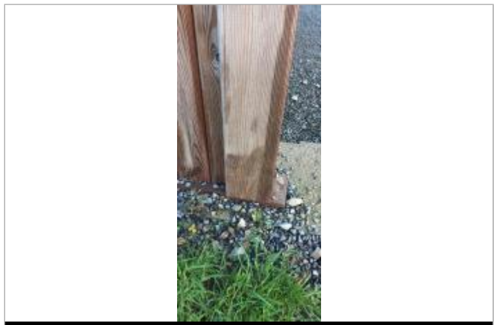
Marque sur le poteau d'un abri vélo du parking
