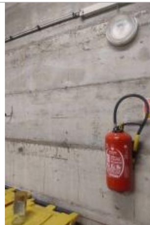
Vue du mur portant des traces de feutre
