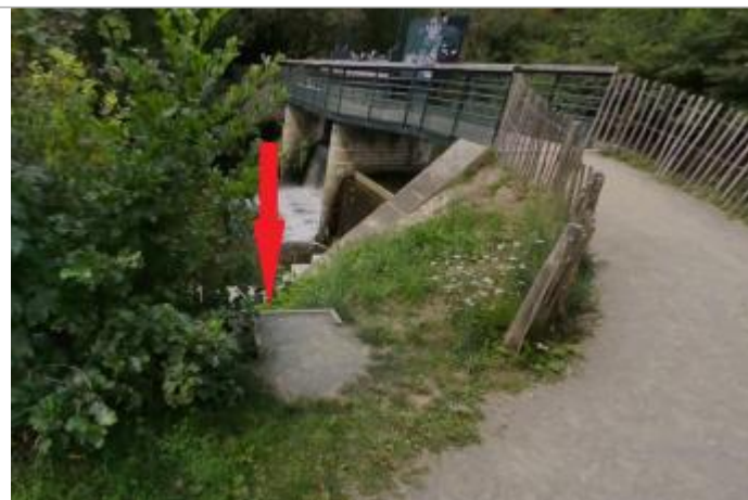
Escaliers près du vannage en rive gauche (photo Harry Trib en août 2025)
