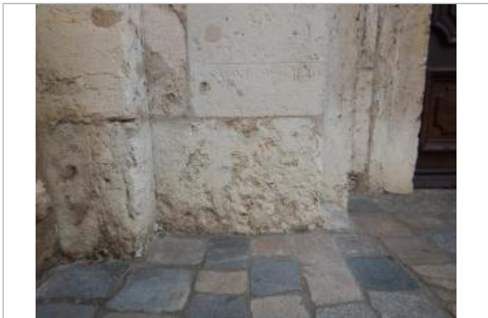
Repère de crue gravé sur le mur. A 66 cm du sol. A gauche de la porte en bois.
