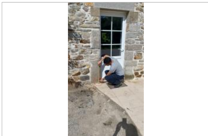
Laisse de crue à 10 cm/sol.
