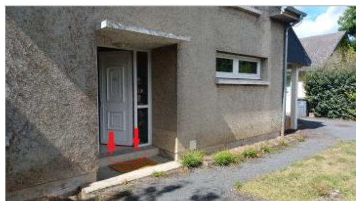
Laisse de crue au niveau du dessus de la dernière marche
