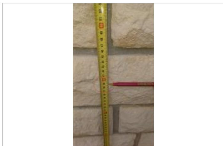
Laisse de crue à 46 cm/ haut de la dernière marche.
