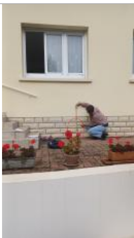
Laisse de crue à 39 cm/sol terrasse.
