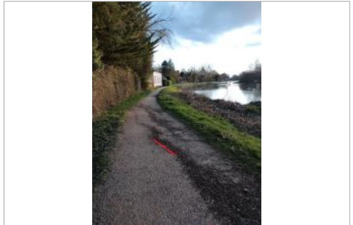
Laisse d'inondation sur le chemin de halage (photo Rennes Métropole)
