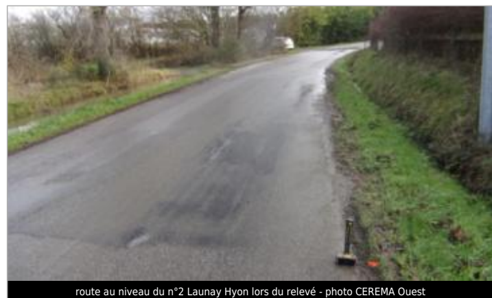
route au niveau du n°2 Launay Hyon lors du relevé - photo CEREMA Ouest
