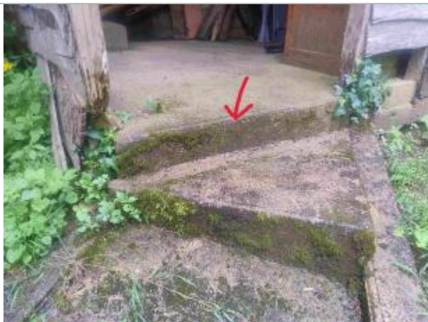
Vue sur la marche identifiée dans le témoignage des propriétaires. (flèche rouge correspond à la hauteur de l'eau en février 2024)
