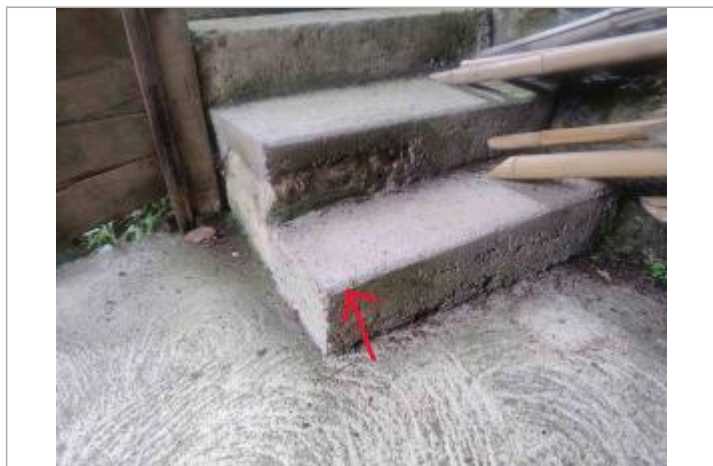
Vue sur la 1ère marche de l'escalier (niveau atteint par le Clain en mars 2020).
