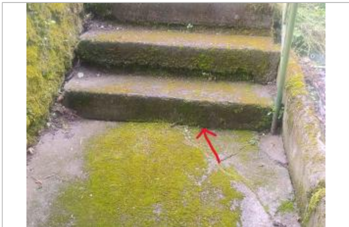
Indication du niveau d'eau atteint (2024) selon le témoignage
