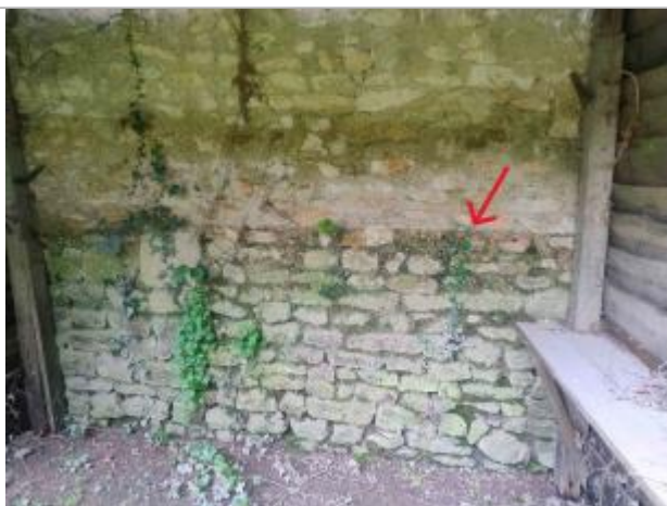
Vue sur la laisse d'inondation
