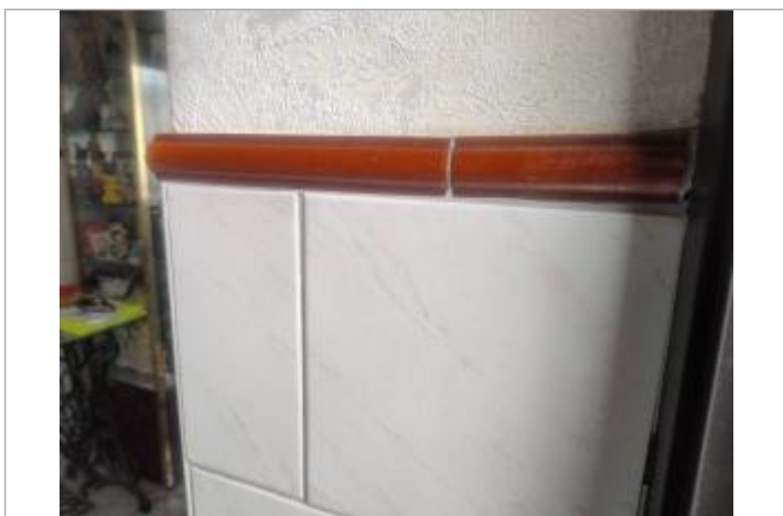
Vue sur la limite supérieur du carrelage
