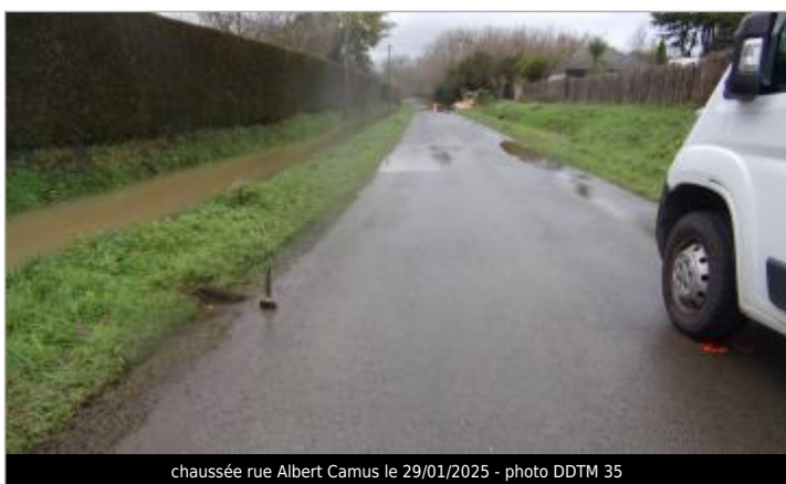
chaussée rue Albert Camus le 29/01/2025 - photo DDTM 35
